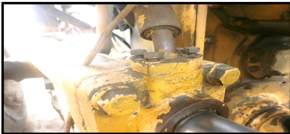
Figura 27: Conexión de las cañerías sueltas y con fugas.
