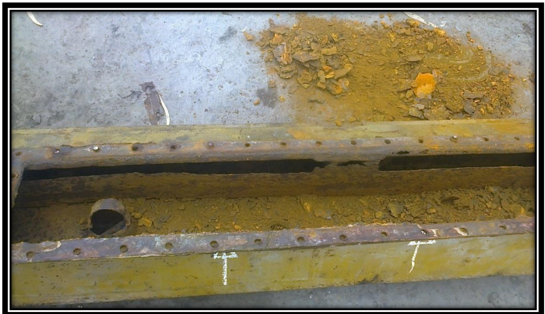
Figura 26: Tapa de radiador corrosivo mal estado
