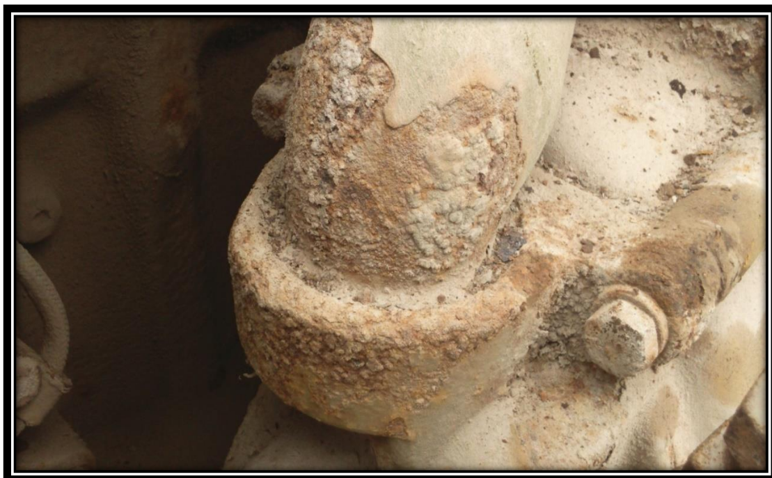
Figura 23: Tubería de agua corroidas
