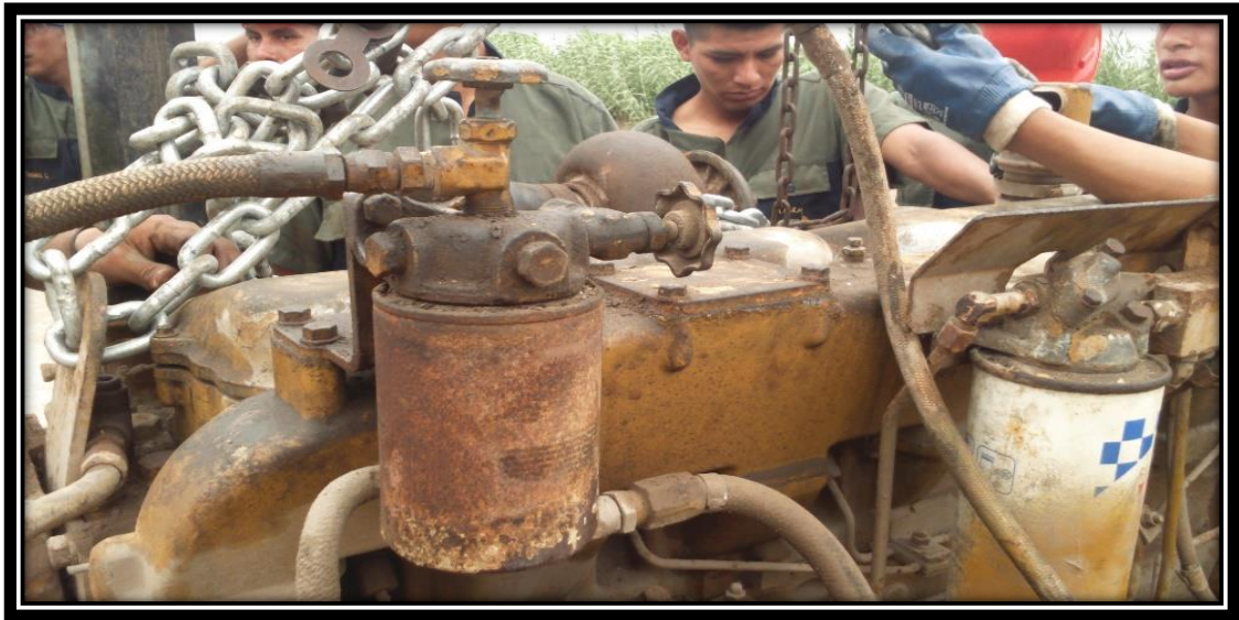
Figura 21: Filtro de agua con desgaste corrosivo y perforado
