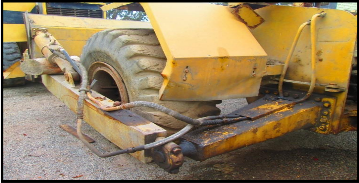
Figura 37. Mangueras y cañerías metálicas hidráulicas de alta presión con fugas, oxido y corrosión, Cilindro de levante con pines y manguera corroída.
