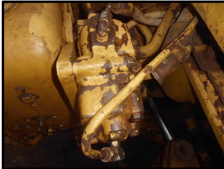
Figura 39: Bomba prioritaria donde se muestra la corrosión de sus componentes.
