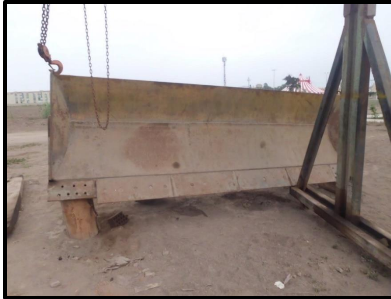
Figura 40: Lampón durante la inspección sensorial. Estructura oxidada, cantoneiras laterales corroídas.
