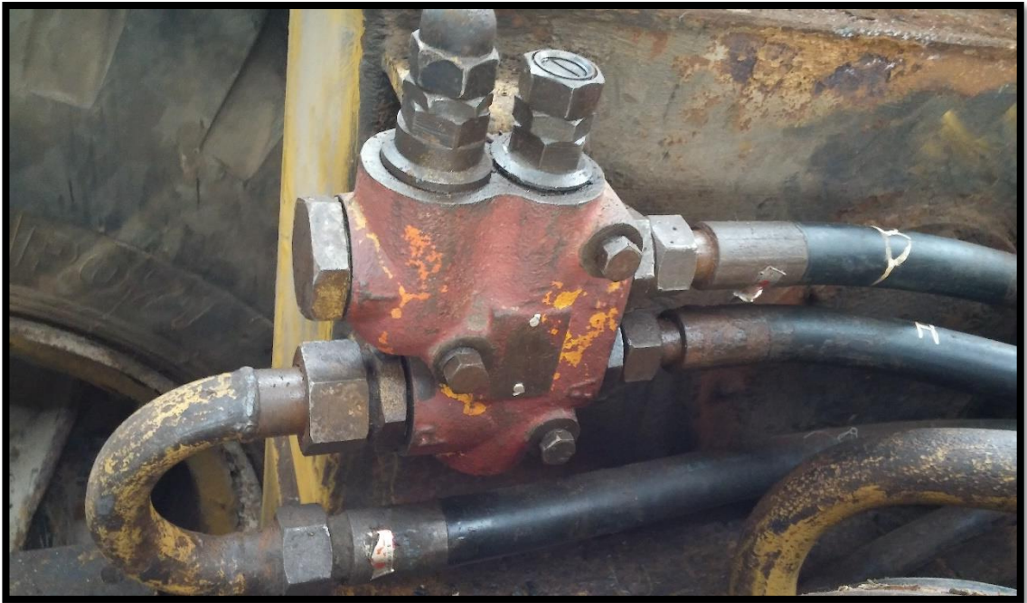
FIGURA 31. BOMBA PRIORITARIA PRESENTA CORROSIÓN DE SUS PARTES Y LA OXIDACIÓN DE LAS MANGUERAS DE ENTRADA Y SALIDA DE FLUIDOS.
