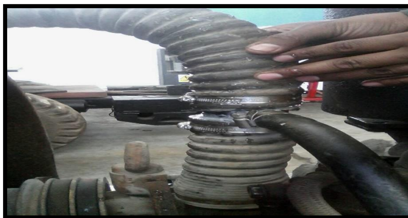
Figura 40. Fugas en Mangueras
