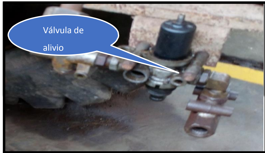
Figura 23. Válvulas de alivio de dos vías
