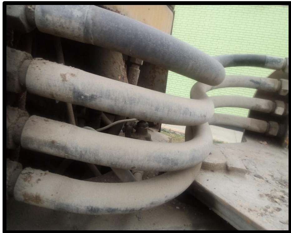
Fotografía 10. Mangueras de alta presión obturadas
